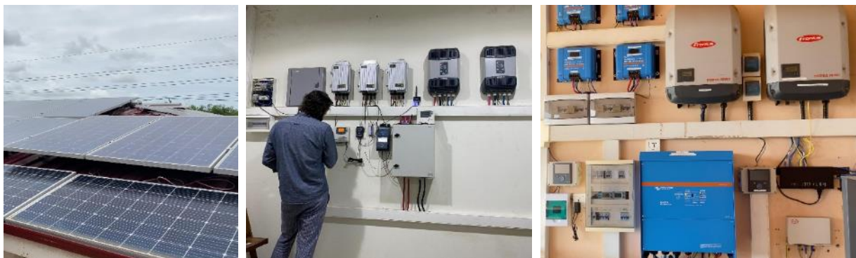
Abbildung 4: Installation des Mini-Grid auf dem Don Bosco Campus in Tema, Ghana: Solarmodule auf dem Dach des Technical Center, Wechselrichter, Laderegler und MPPT im Provincial House sowie in der Kapelle (von links nach rechts)
